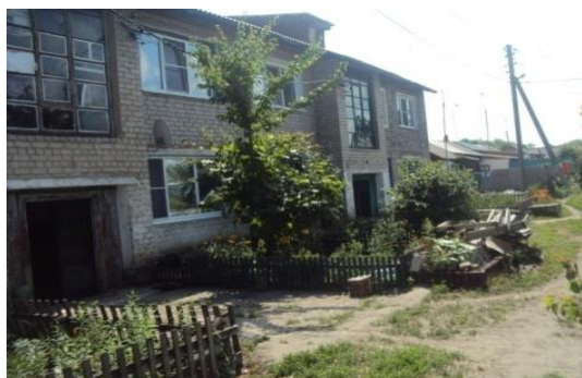
МКД по ул. Совхозная, не имеющий системы водоотведения
