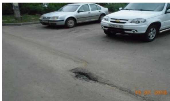
Разрушение стыка а/б покрытия на ул. Вл. Невского, 63
