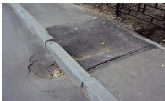
Некачественное восстановление тротуара на ул. Жигулевская, 28а
