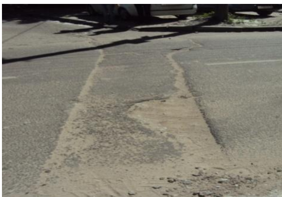
Разрушение асфальта после производства земляных работ
