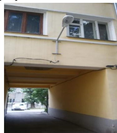
Вновь установленное освещение по ул. Кольцовская, 47
