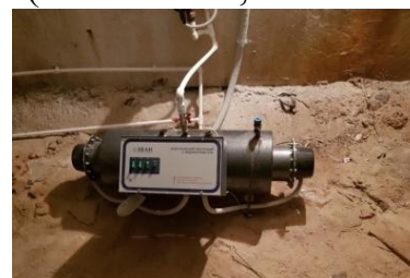
Нарушение технологии производства работ ведет к эксплуатационным рискам
